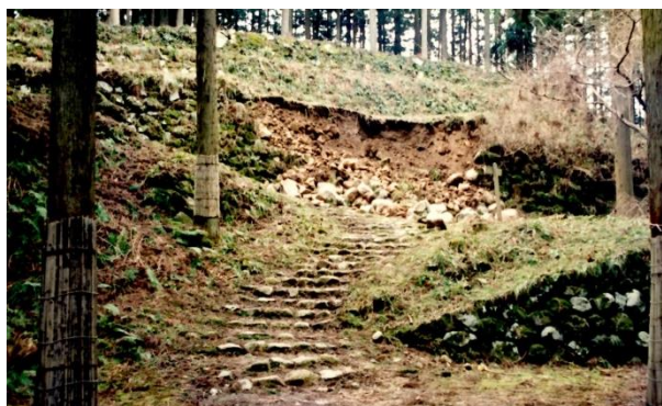
写真 24 A0404(H元、崩落後)
