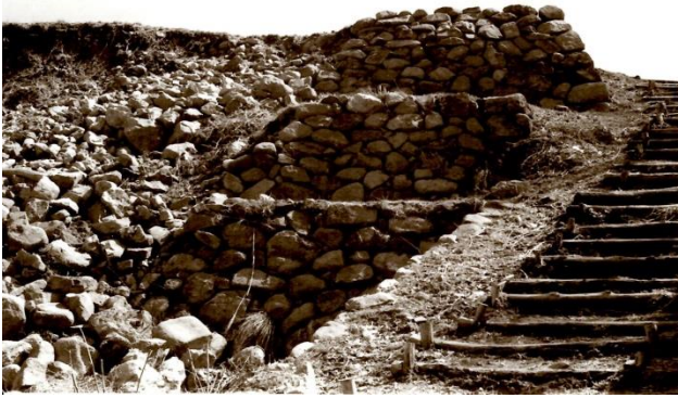
写真 14 A0101～103 崩落状況(S38)
