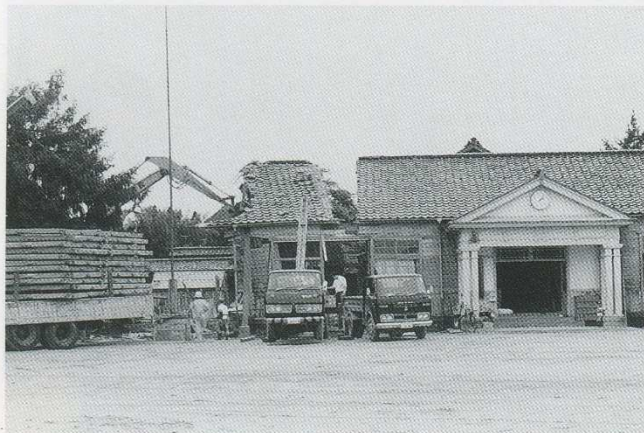
校舎左側の大半が取りこわされている。職員室が二分されたところである。
