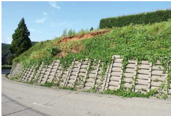
2号墳側崩落 (平成 30 年 9 月)
