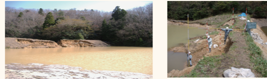
photo: 被災後の平田池の堤体
