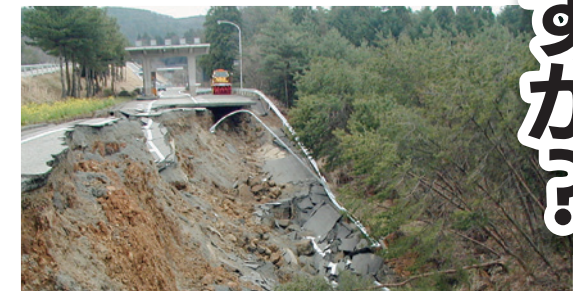
平成19年3月25日の能登半島地震で崩落した道路
