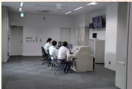
①中央制御室
