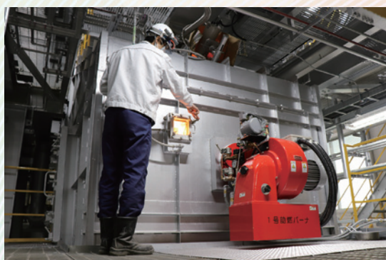
③バーナなどの内部設備
