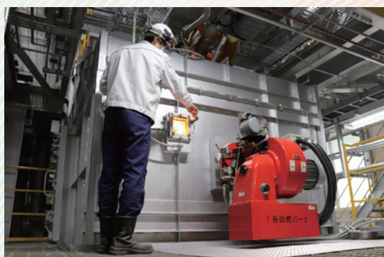
③バーナなどの内部設備
