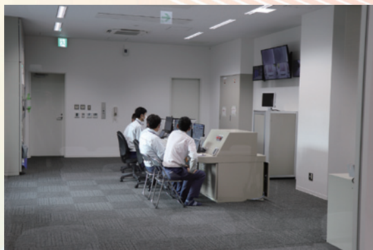
①中央制御室
