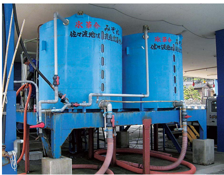
海水シャーベット氷施設
