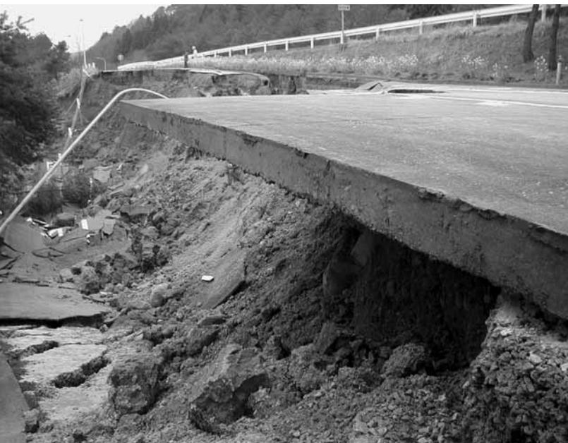
能登有料道路上り線横田料金所付近の陥没
