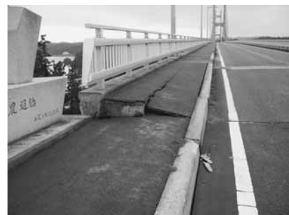
結合部にたわみが生じた農道橋
