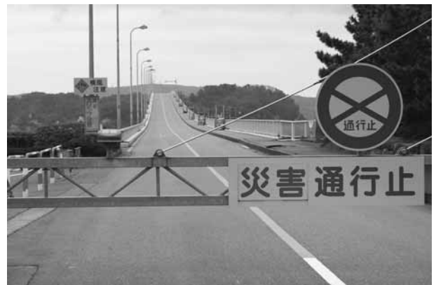
橋脚の亀裂により能登島大橋が通行止めに
