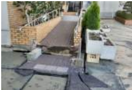
復旧前（袖ヶ江地区コミセン）
