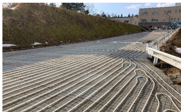
【写真②】ロードヒーティング配管状況
