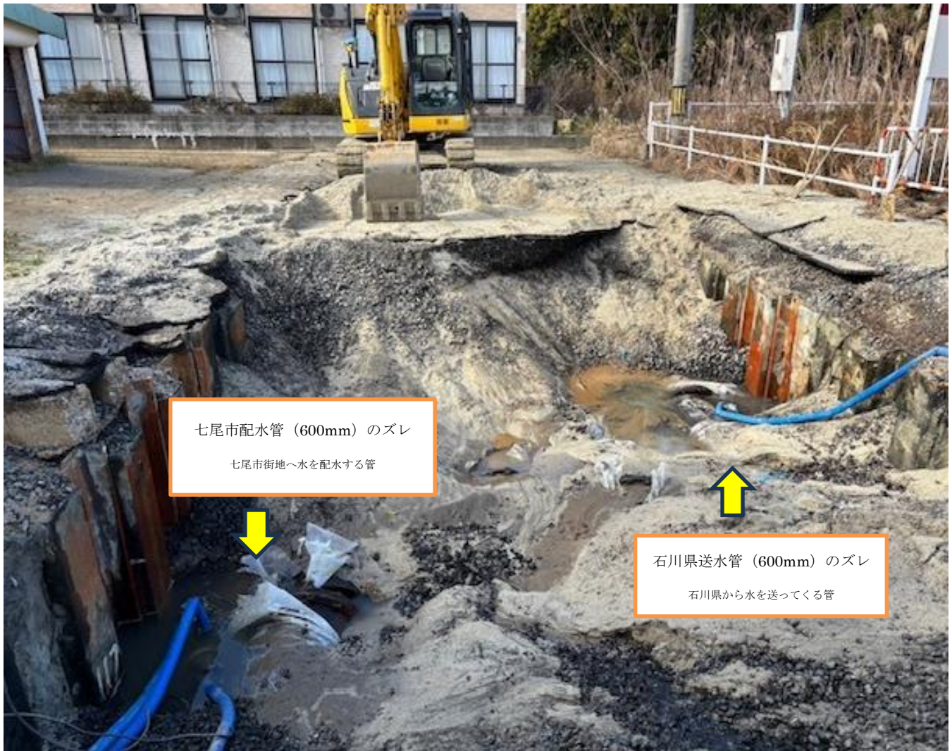
岩屋浄水場付近道路の陥没状況
