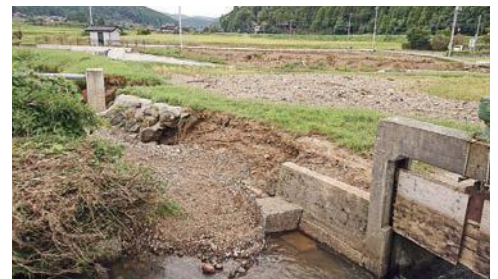
豪雨による農地被害（用水路）
