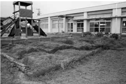
大きな亀裂が入った保育園のグラウンド
