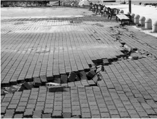
わくわくプラザ（和倉地内）の液状化現象による陥没
