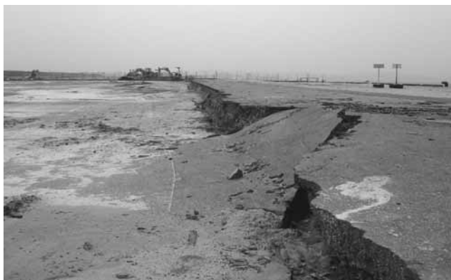
液状化現象で段差ができた大田埠頭
