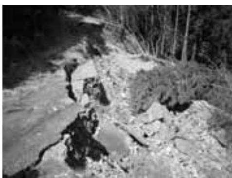
市道長根尾岡上線の被害状況。年内に復旧予定。
