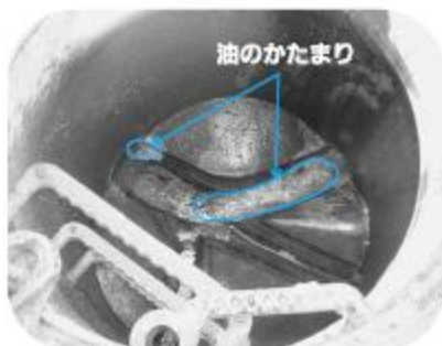
污水管をつまらせた原因はこれです。
