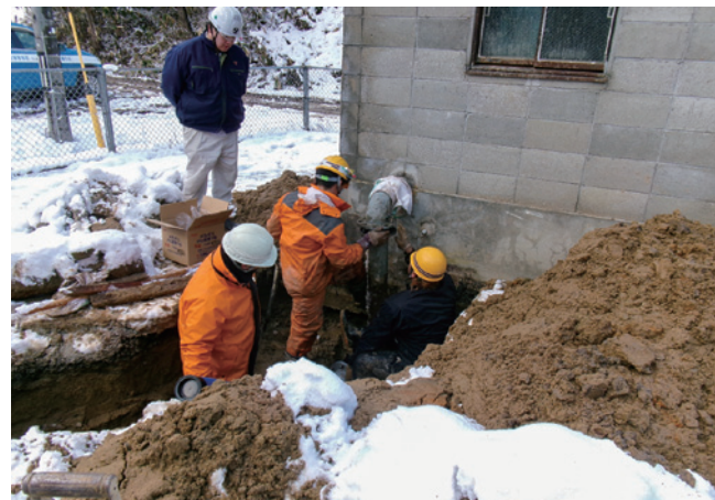
1月24日 赤浦1号井戸水道管敷設作業 (名古屋市上下水道局 提供)
