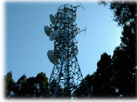
防災行政無線設備の被災
